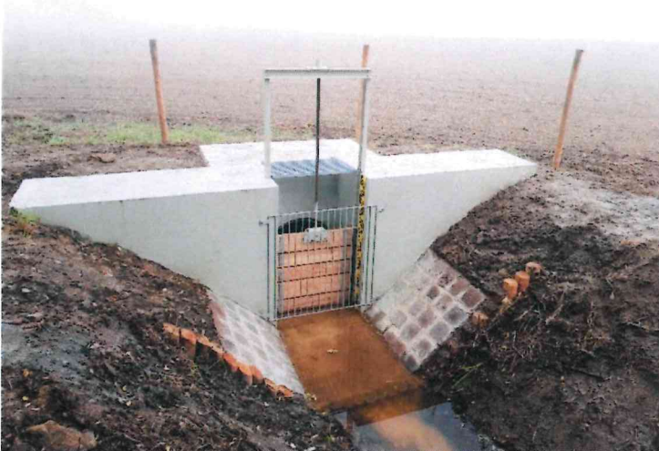
Kleine Anlage danach (vollständig betriebsfähig)
