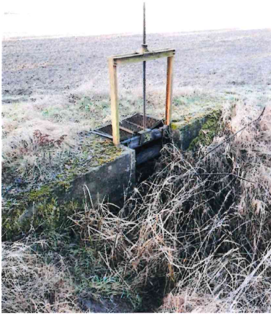
Kleine Anlage vorher (eingeschränkt betriebsfähig)
