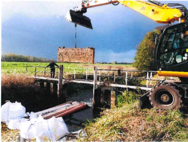
Mittlere Anlage während
